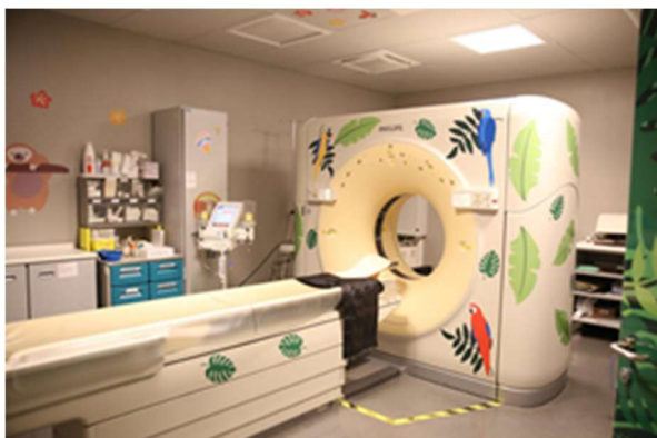
Figura XIX: apparecchiatura TC con pompa per il mezzo di contrasto e carrello contenente gli utensili utilizzati per l'esecuzione degli esami e per gestire le emergenze/urgenze presso la clinica pediatrica Meyer.
